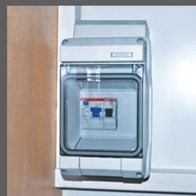
Verteilerkasten mit FI und Sicherung (16 Ampere)
